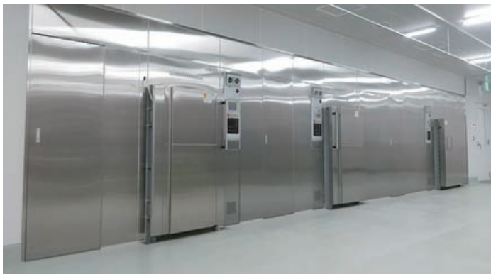
高圧蒸気滅菌装置
